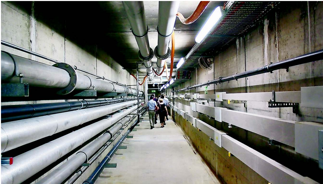
Die Führung durch die Abwasserreinigungsanlage ging hinunter bis in den Keller.
